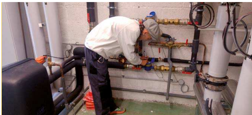
▲ Suivi énergétique des installations de la piscine A. Jany
